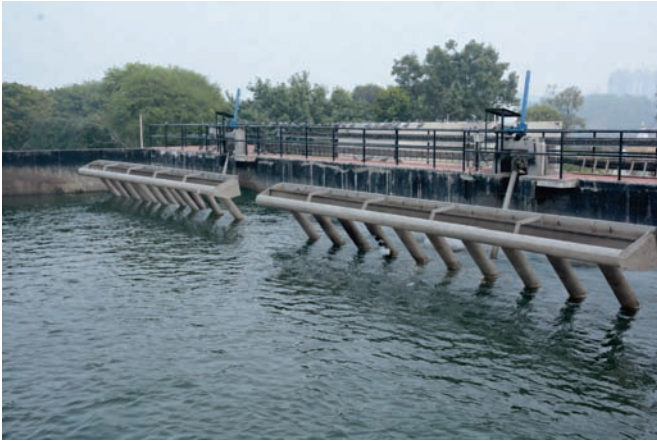
30 MLD STP KOTA (SBR Decanter)
