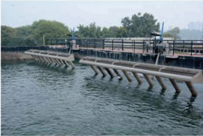
30 MLD STP KOTA (SBR Decanter)
